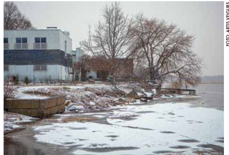
Teātra un Kalnciema ielas rajonā Lielupes ūdeņi ir tuvu krasta apbūvei un pakāpeniski noskalo krasta grunti. Saglabājušās pirms daudziem gadiem būvētā krasta stiprinājuma atliekas, par iedzīvotāju centieniem nostiprināt krastu liecina piegružojums ar betona blūkiem. Krasta nogāze tiks sakārtota un nostiprināta, saglabājot šos kokus, piekļuvei pie upes izbūvēs kāpnes.
